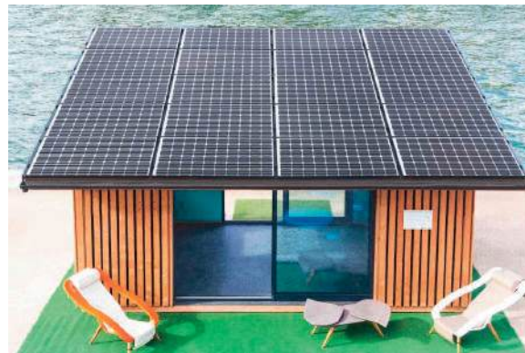
Figure 1. Panneaux photovoltaïques sur un toit plat
