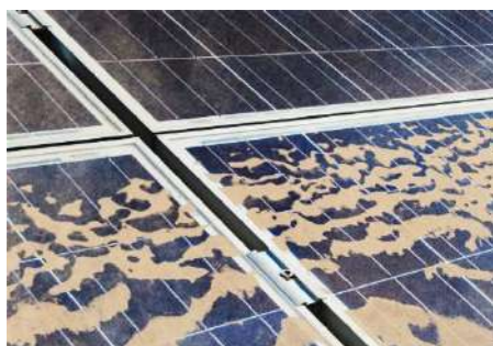
figure 17 : modules couverts de salissures.
